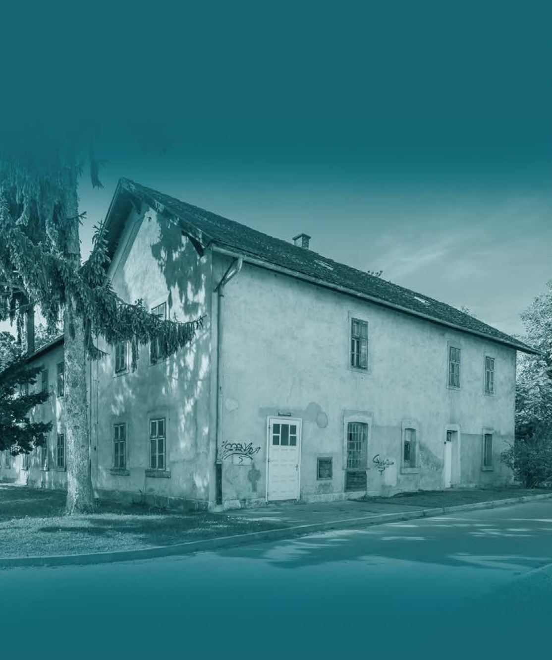
Zgrada Tehničke službe („stolarija“) koja će se rekonstruirati u prostor za radnu terapiju
